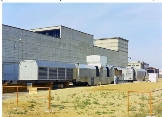
Groupe électrogène mobile Turboma, équipé d'une turbine à gaz M38, pour l'Iran en essais sur Villaroche(© Espace Patrimoine Safran)
